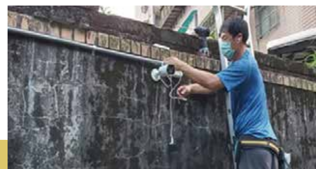
裝設CCTV監看後山滯洪池
