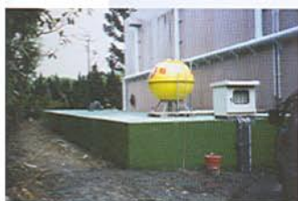
行政大樓雨水貯留系統 (150立方公尺)
