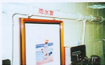
廁所雨水沖廁管路
