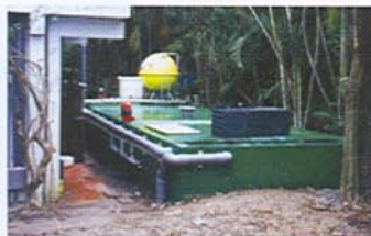
藝品區雨水貯留系統(50立方公尺)
