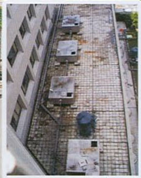
慈濟醫院三樓雨水貯槽及處理系統
