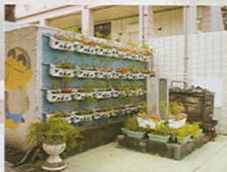
20立方公尺雨水貯水槽與 植栽美化
