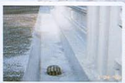
利用既有廣大乾淨收集面收集雨水
