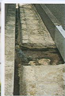
集水區落水頭設備
