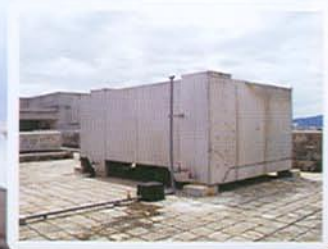
校舍頂樓不鏽鋼配水槽及流量監測設備
