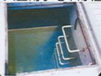
大型雨水地下貯槽
