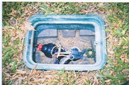
噴灌設備Y型過濾器
