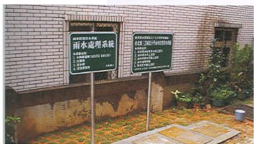
雨水處理系統及戶外緩衝槽
