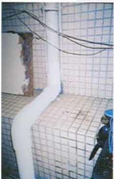
利用既有管路接用雨水
