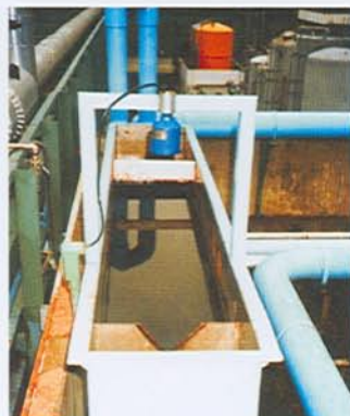
進流渠設置超音波流量計控制入流量
