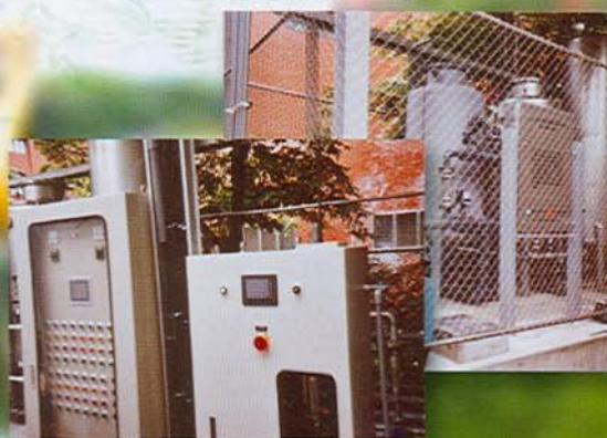
HMI人工界面及臭氧產生設備
