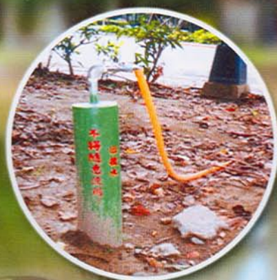
活性炭吸附設備
