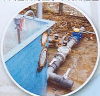
離子交換逆洗水貯水槽
