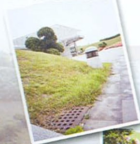
地面雨水逕流收集溝
