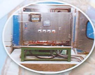
水質監控設備
