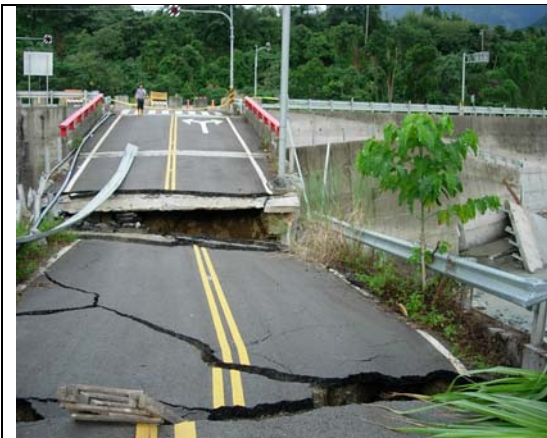
清水溪-龍門大橋塌陷情形 1
