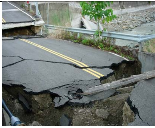
清水溪-龍門大橋塌陷情形 2
