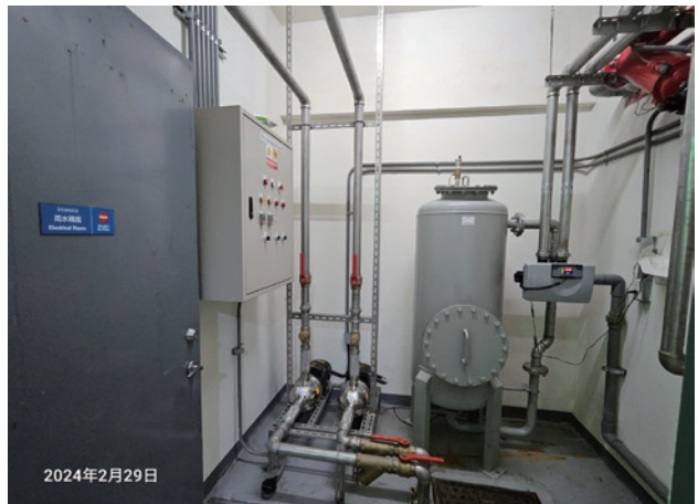
圖 1、研創大樓雨水回收系統
