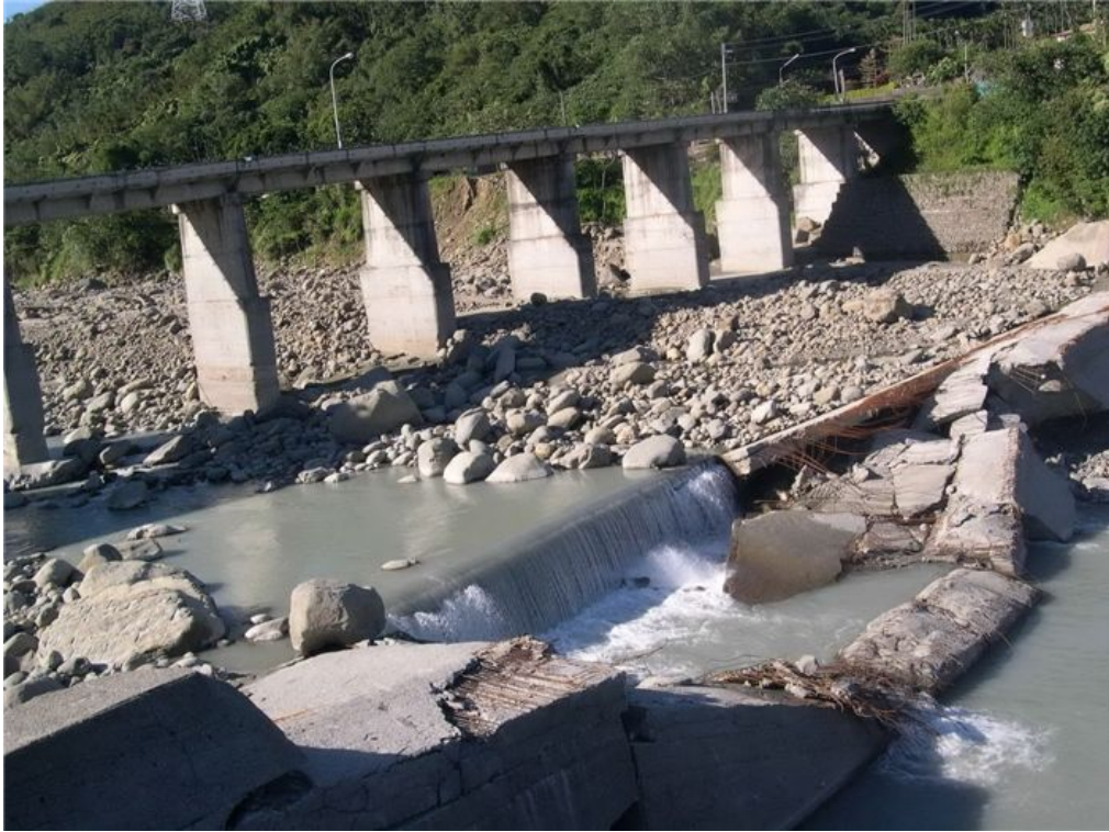
圖 24. 清水溪行正橋下防砂壩照 (2008 年 11 月)
