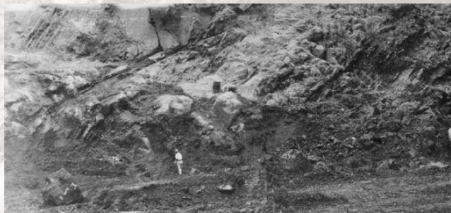
▲ 民國 48 年 6 月大壩基礎開挖後，大壩左山脊有明顯的裂縫及節理。上圖紅線為標高 160 公尺附近。
