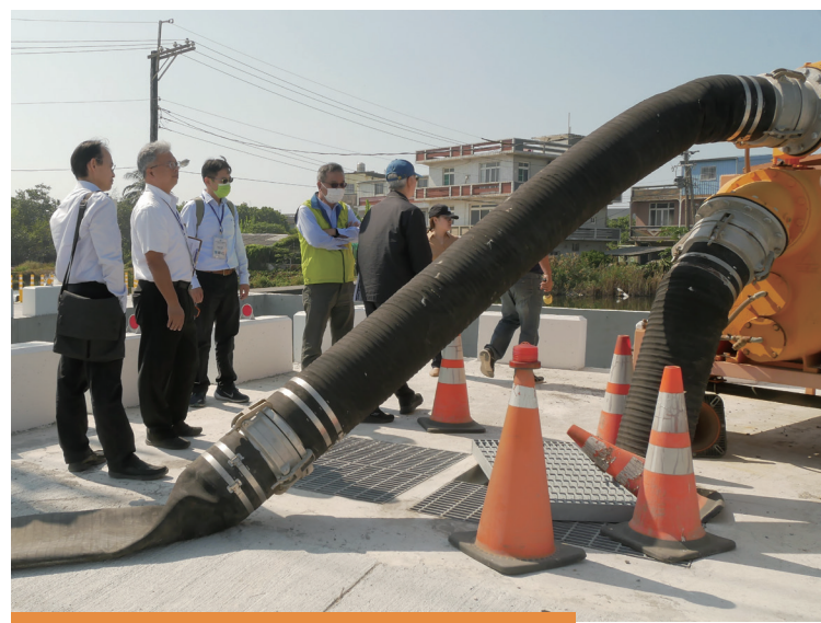
高雄市永安區新港里 - 測試魚塢預排抽水機功能
