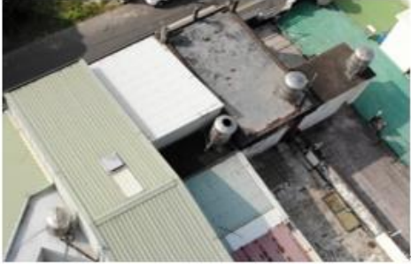
水塔未加蓋情形
