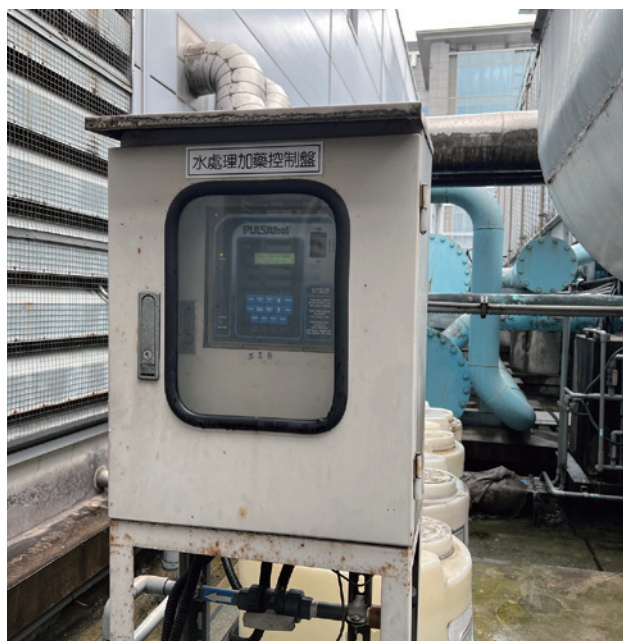
圖 3、空調冷卻水安裝自動加藥設備
