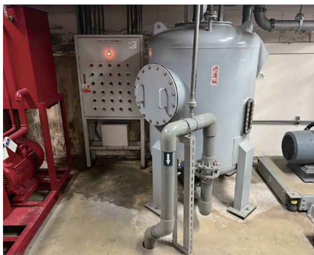
圖 4、雨水過濾設備
