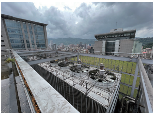
圖 2、空調冷卻水塔安裝溫控啟停控制
