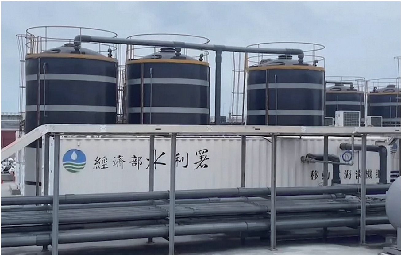
圖 4、永安興達電廠設置緊急海淡機組
