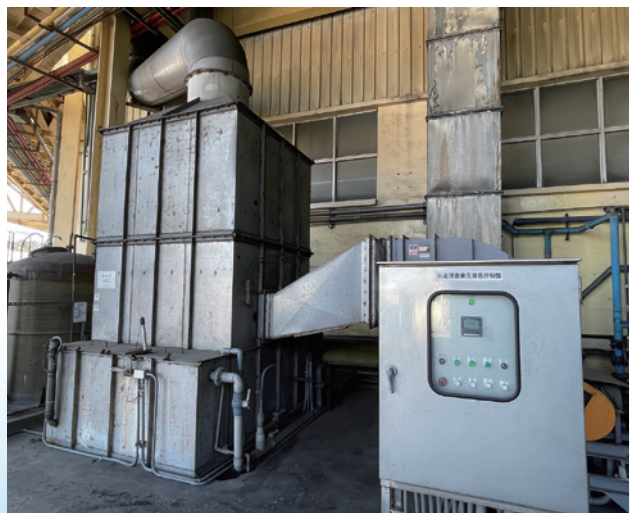
圖 5、塗裝前處理廢氣洗滌塔節水改善利用
