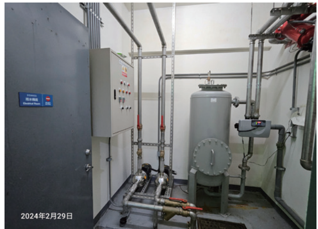
圖 1、研創大樓雨水回收系統
