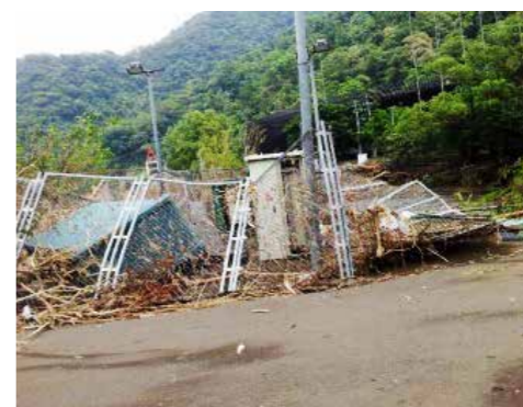
大雨造成路基掏空 / 圖片來源：水利署
