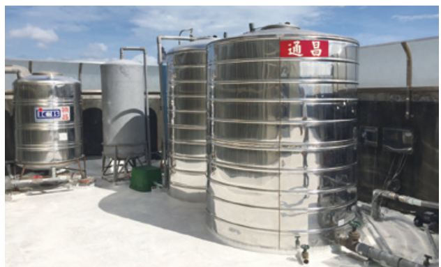
雨水過濾器及沖廁儲存桶
