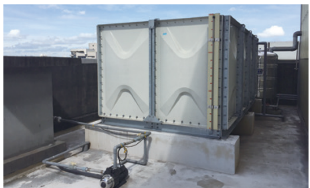
頂樓雨水儲存槽
