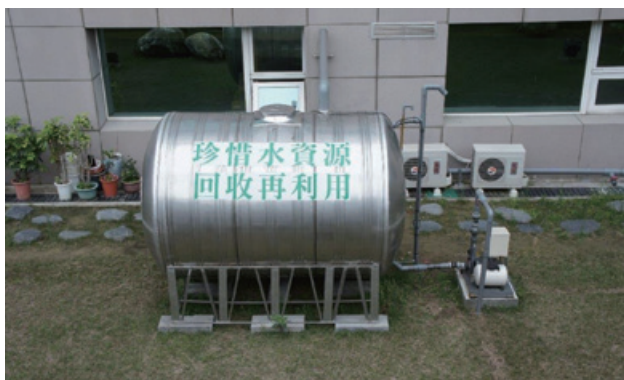
圖 4. 空調冷凝水，飲水機 RO 廢水回收系統
