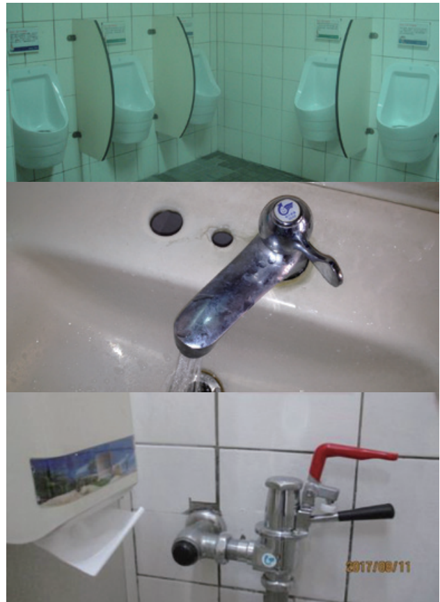
節水設施(上:免水小便器;中:省水龍頭;下:兩段式沖水器)
