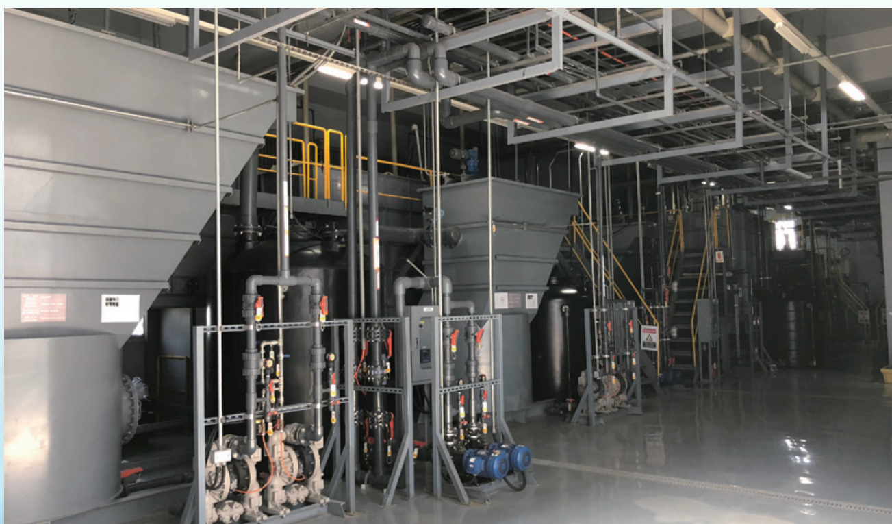
電鍍製程廢水回收再利用前處理設施
