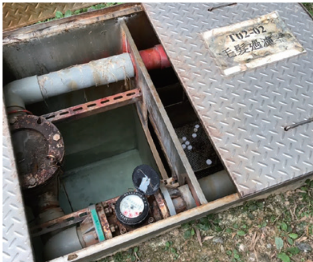
圖 6 溫泉及泳池放流水回收槽及過濾器
