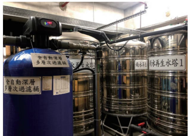
雨水收集系統設備
