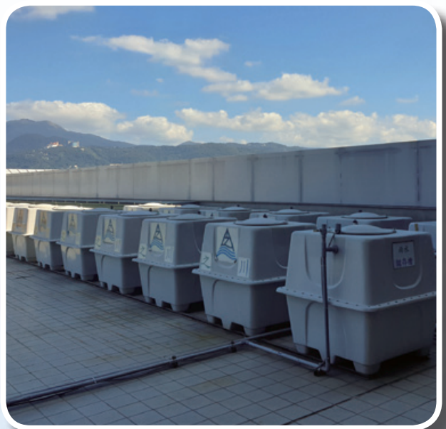
圖 4、屋頂戶外雨水儲存桶
