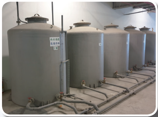
圖 6、屋頂室內雨水儲存桶
