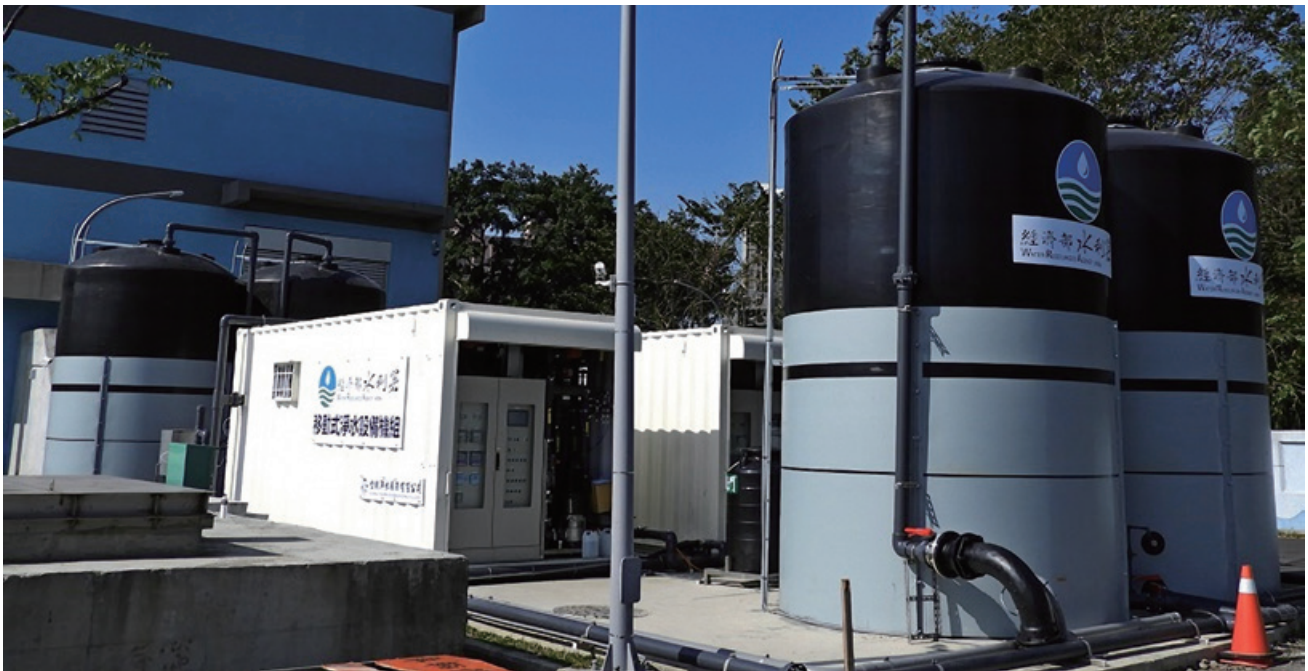
圖 2、新北樹林浮洲加壓站砂濾級移動式淨水設備
