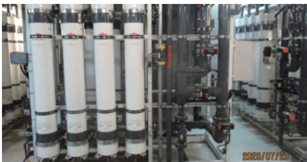
圖 3、SAW 切割廢水回收系統 (UF 超濾膜)
