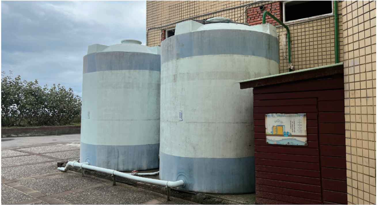
圖 3、海洋大學河工二館雨水貯集桶
