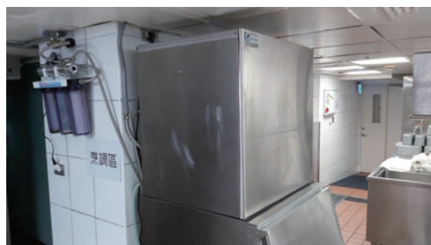
圖 7、製冰機全密閉式自來水接管循環散熱實照
