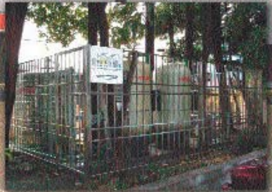
▲ 雨水/再生水(中水)聯合處理系統 (南區水資源局第二辦公室與第七河川局合署)
