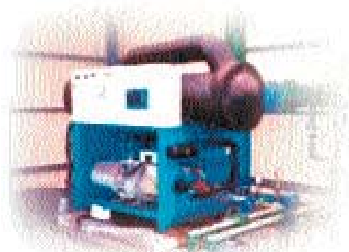
▲ 乾燥機設備冷凝水回收
