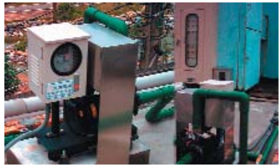
▲ 雨水供水泵及第二水源自動控制設備
