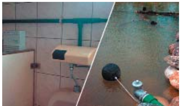
▲ 收集的雨水供應沖廁與生態池補水
