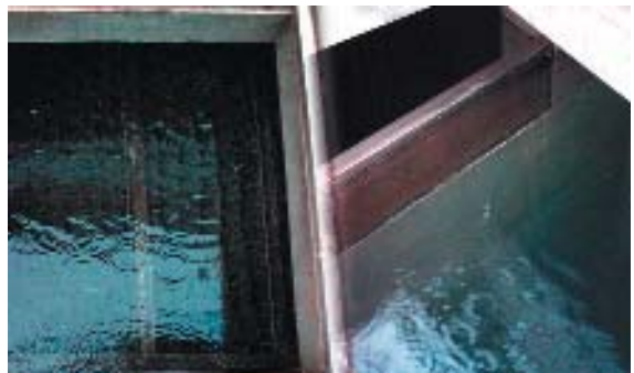
▲ 傾斜管處理設施與乾淨的雨水資源
