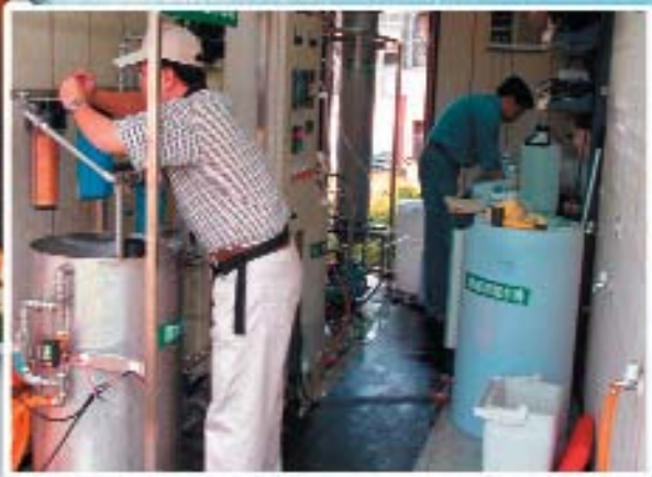
▼ 深層海水造水機組
