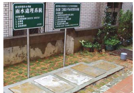
設置於三芝國小之雨水貯留供水系統
