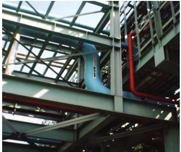
雨水回收管路
