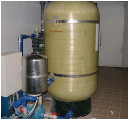
利用位於地下樓的筏基做為雨水貯蓄池。
