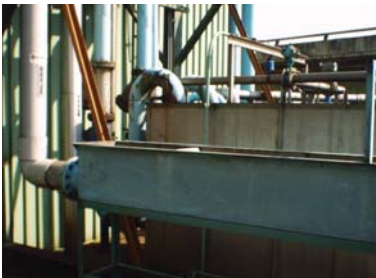
雨水回收水計量槽
