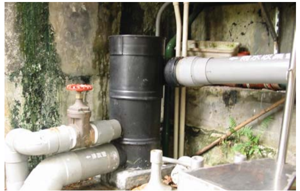
平溪國小的雨水收集管線相當粗大，雨水利用十分徹底。
