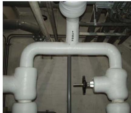
慈濟技術學院浴廁用水管路
