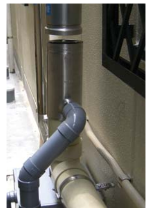
民宅採用德國管式雨水過濾器收集雨水利用
