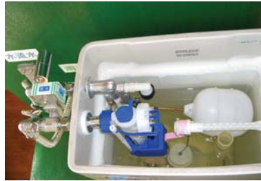
自來水及雨水兩用之沖水馬桶，此套系統亦已於相關民宅使用。
