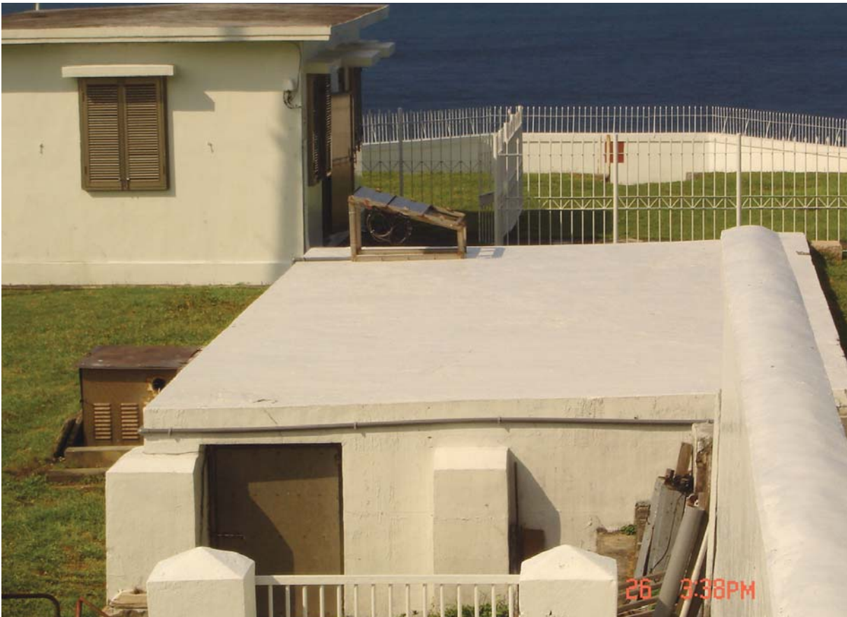
建於日據時代之40噸雨水貯槽，因槽體漏水，現已改為儲物間。（鼻頭角燈塔）
