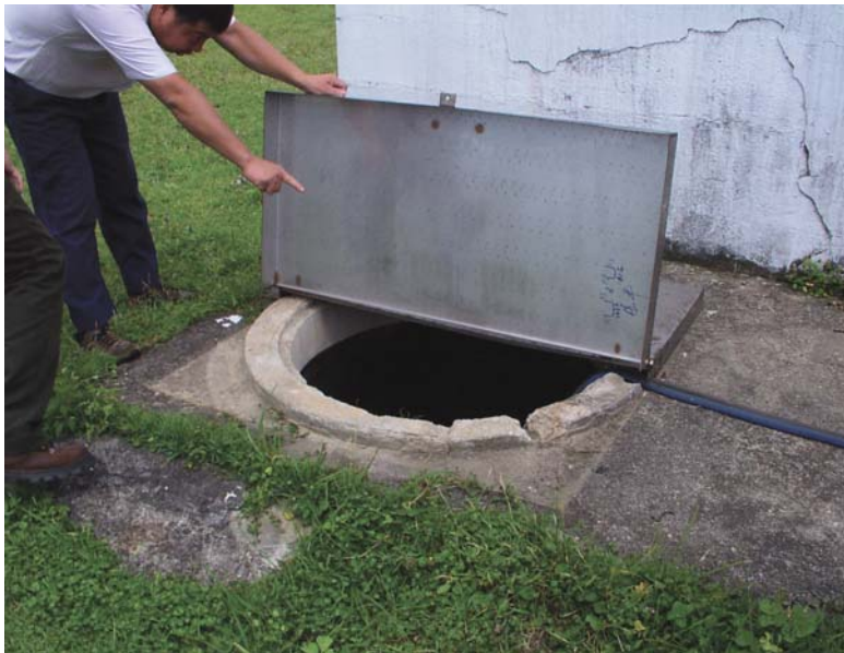
10噸雨水地下貯槽，供燈塔清洗。(鼻頭角燈塔)
