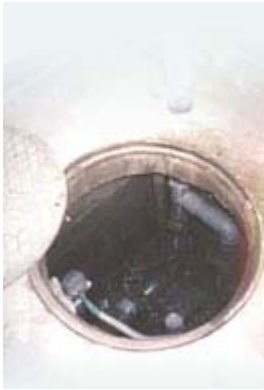
位於筏式基礎內之雨水貯水槽(透明清澈之雨水)
