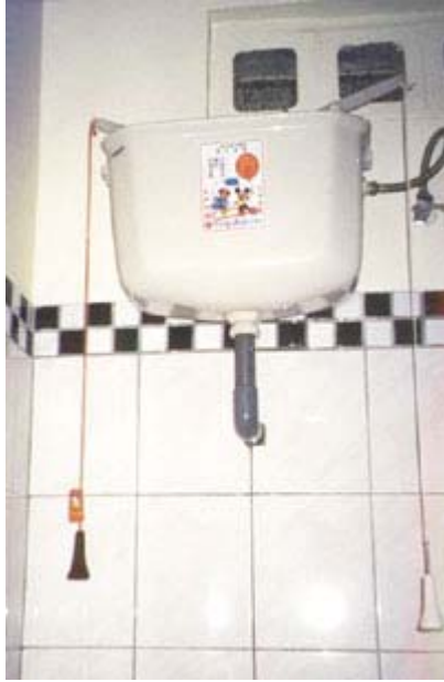
省水器材之安裝 (高水箱二段式沖水器；社寮國小)
