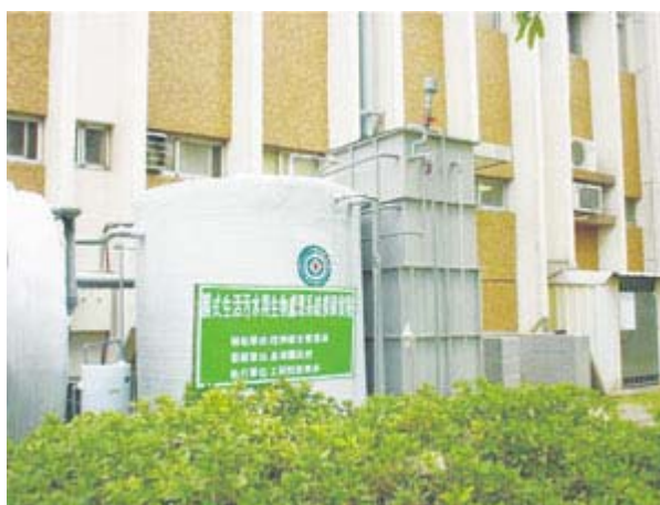
▲ 照片 4-2 沈浸式膜再生水處理系統外觀
