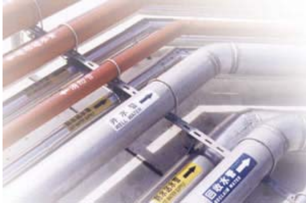
▲ 圖 4 建築物管路分流及標示
