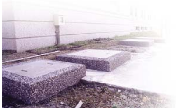
▲ 圖 5 技術學院宿舍區雨水戶外處理兼緩衝槽設備
