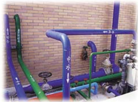
▲ 水管管線以顏色標示，利於辨識及管理
