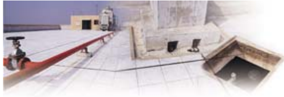
▲ 雨水貯留系統
