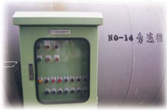
▲ 圖 2 高雄煉油廠旁濾槽操作自動化
