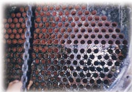
▲ 冷卻主機安裝永磁式磁能處理器後無水垢和腐蝕現象
