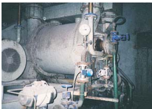
▲ 煉鋼真空泵浦改用直接水，節省自來水耗用
