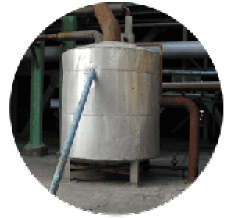
▶照片三：改善前沖放水經沖放槽排放情形
