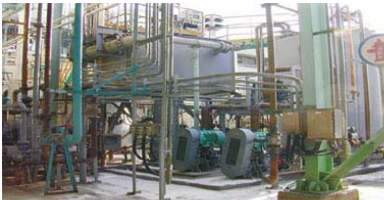
▶照片七：回收水泵出口連通至 FGD 混合水槽情形
