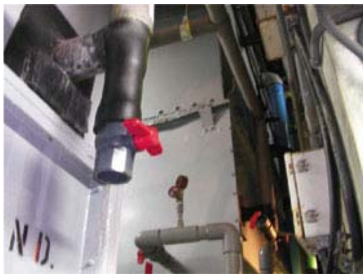
▶冷凝水回收管至蒸發冷凝器
