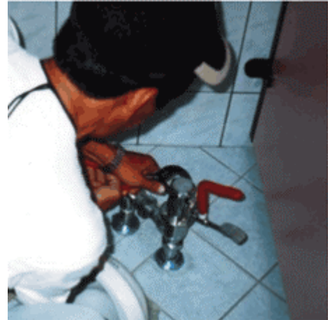
▶圖 15.沖水凡而功能異常維修情形
