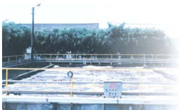
廢水二級處理池
