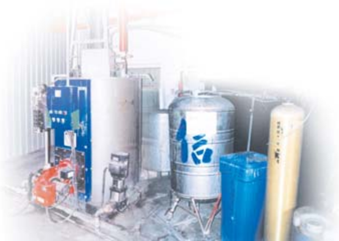
鍋爐蒸汽水回收貯存
