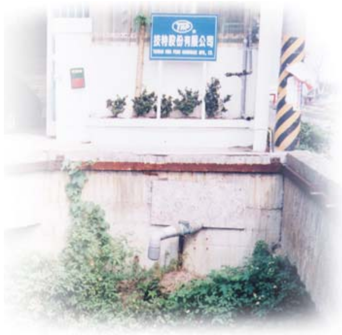
技特公司廢水排放口完全封閉
