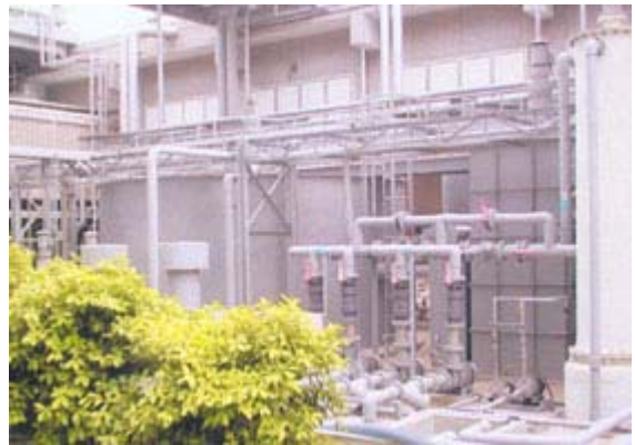
▲ 廢水處理系統
