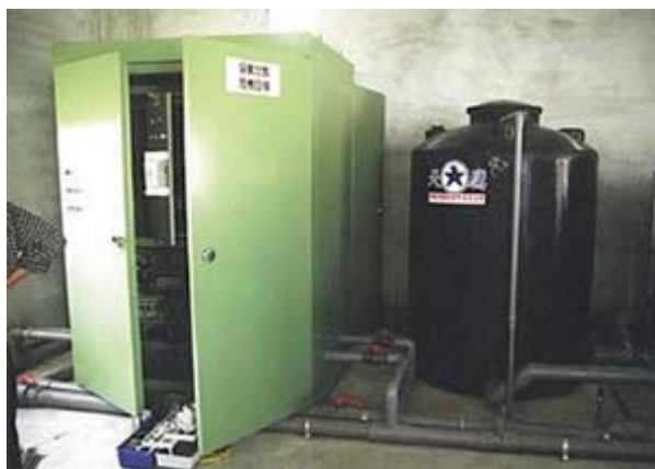
▲污水處理系統
