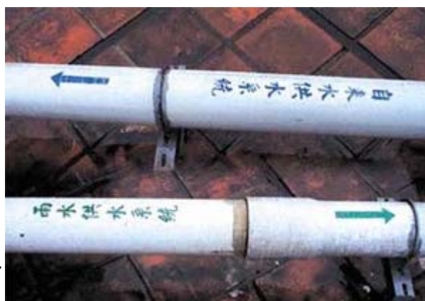
▲不同供水系統顏色區分別文字明顯標示(既有管路修改)
