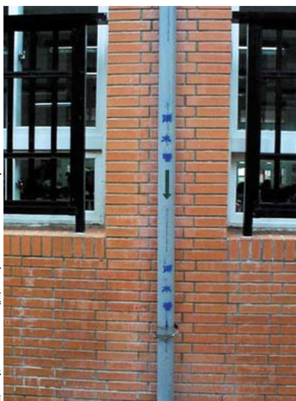
▲既有建築物利用明管(既有管路)收集，易於施工維護
