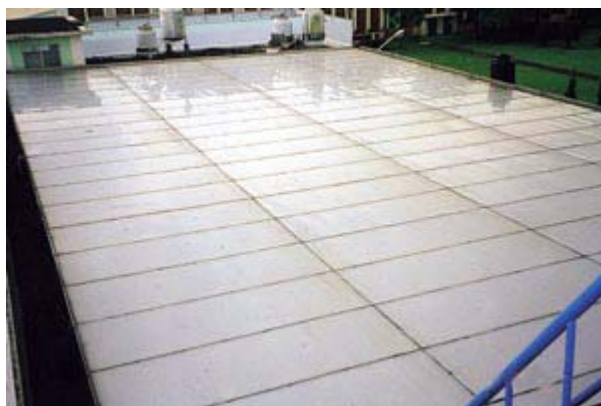
▲不鏽鋼材質集水區域（工研院能資所 24 館）
