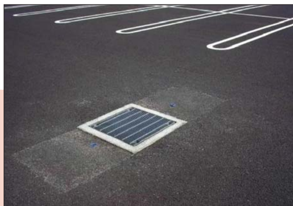
郊外停車場採用雨水浸透設施及貯留設備
